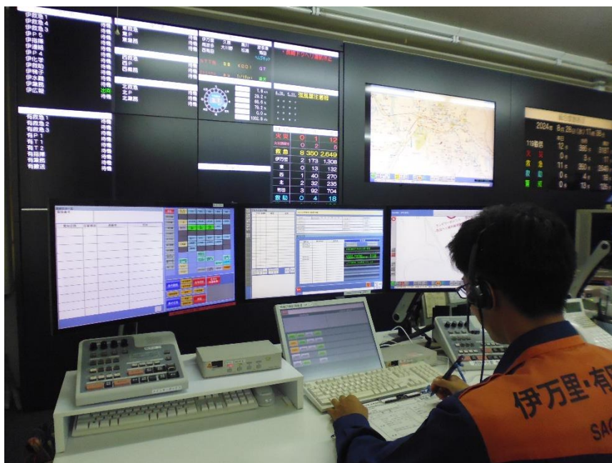
高機能消防指令システム
